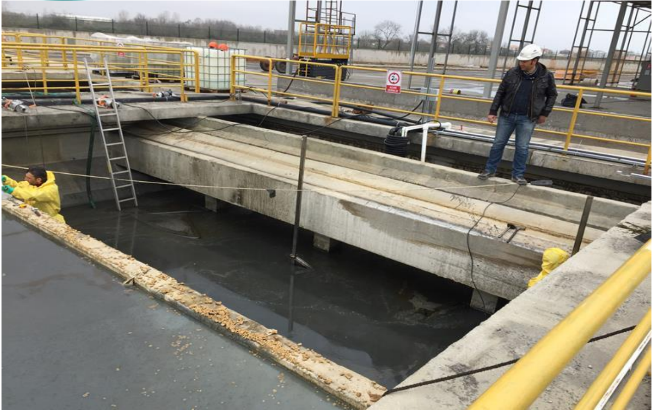
Longitudinal Settling Basin Sedimentation
