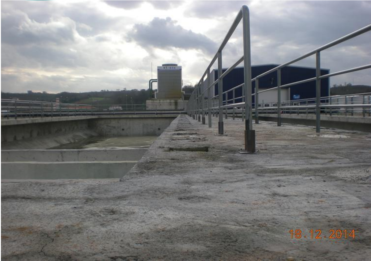
Longitudinal Settling Basin
